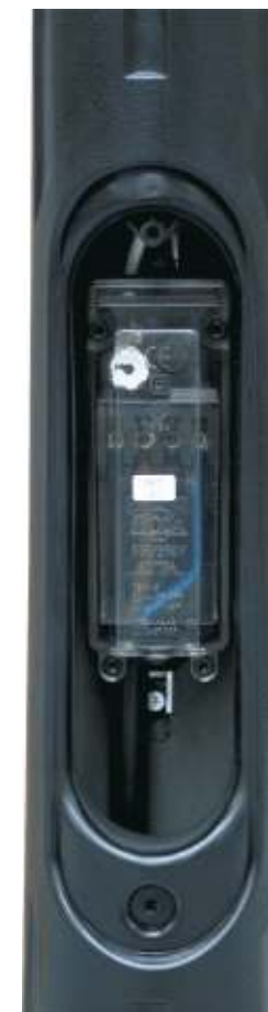
Złącze słupowe we wnęce słupa o zewnętrznej warstwie z tworzywa sztucznego
