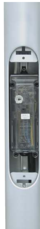
Вводный щиток в нише алюминиевой опоры
