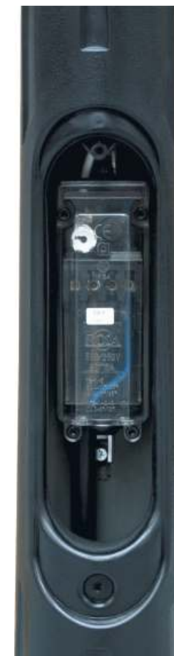
Вводный щиток в нише опоры с внешним покрытием из синтетического материала
