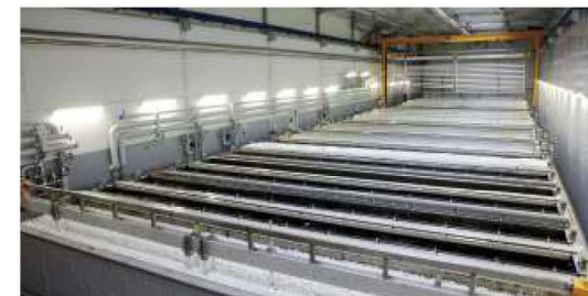
Anodownia ROSA – wanny technologiczne do kąpeli
